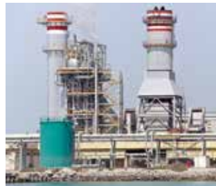
IMPIANTI PER LA DISSALAZIONE
